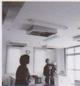
火災警報器の動作確認の様子です
